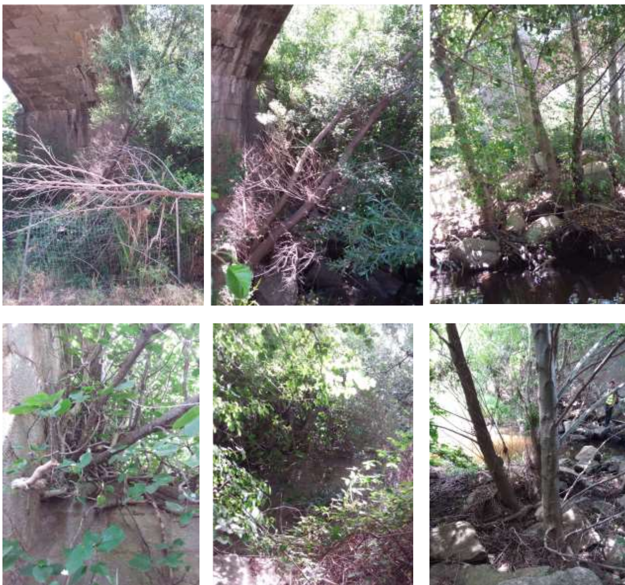
Figura 10 – Le immagini documentano alcune situazioni ove la densità di massa vegetale ha occupato sia la luce libera delle arcate del ponte che la stessa struttura muraria la quale –specie in corrispondenza degli elementi di spalla- presenta i paramenti occupati da esemplari arborei ben sviluppati radicati nei giunti dei blocchi murari.
