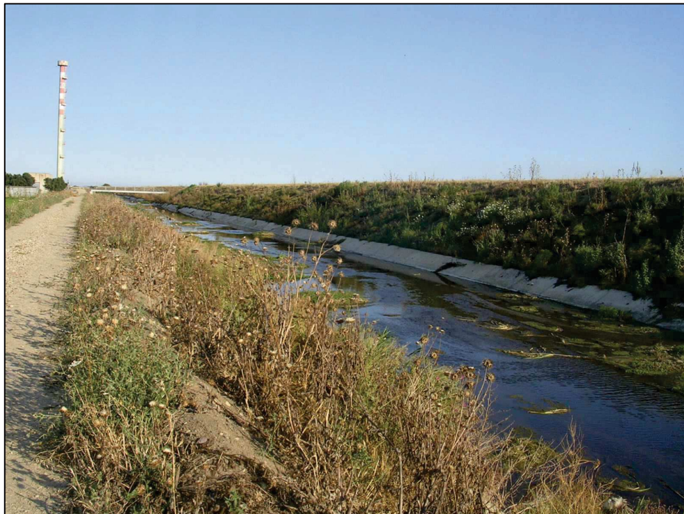
Figura 6.6 – Sistema di raccolta acque in sponda sinistra del Flumini Mannu – colatore principale
