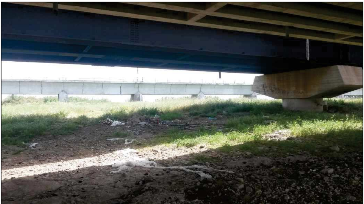
Figura 6.12 – Zone golenali con importanti depositi sotto il ponte sulla SS 130.
