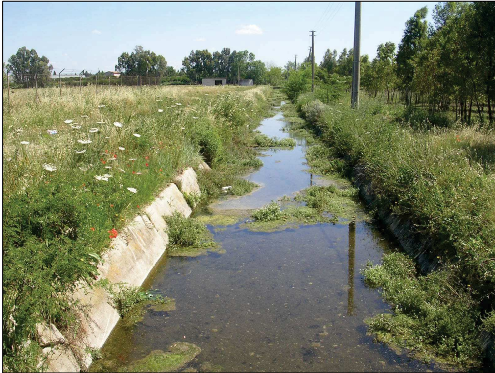
Figura 6.5 – Sistema di raccolta acque in sponda sinistra del Flumini Mannu
