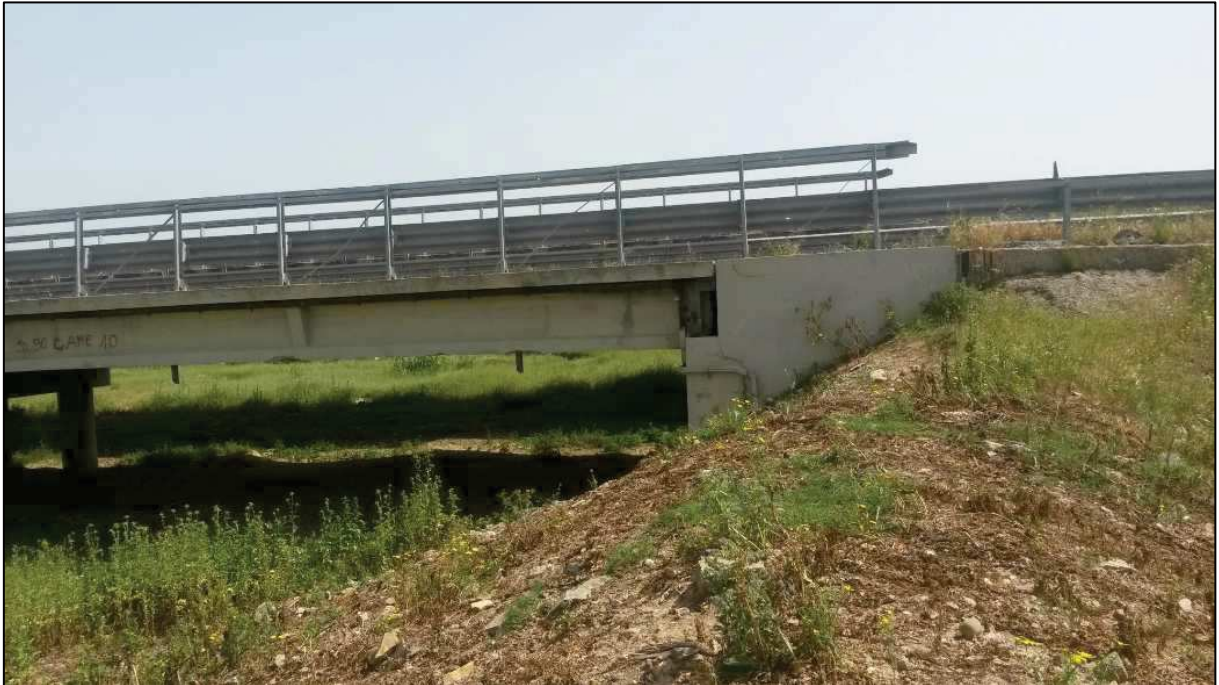
Figura 6.15 – Argine destro intestato sul ponte SS 130 (coronamento a quota intradosso).
