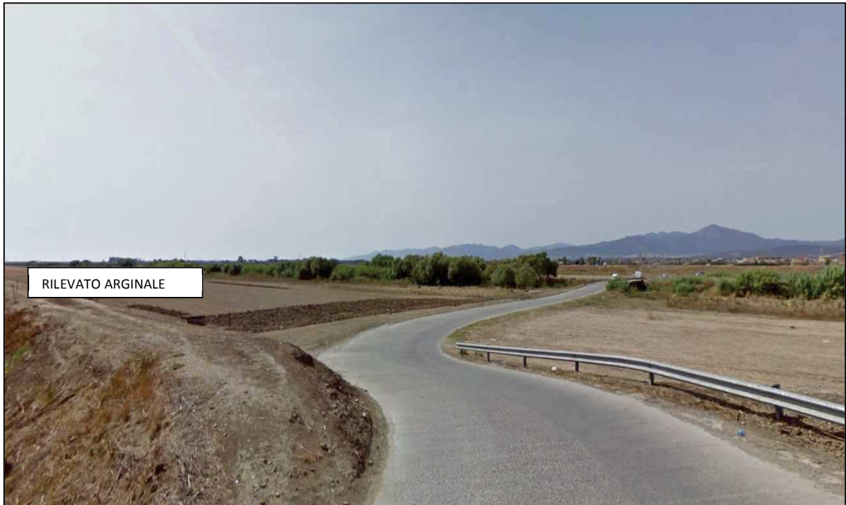
Figura 6.4 – Argine sinistro al guado della forestale (mediocre stato di manutenzione)
